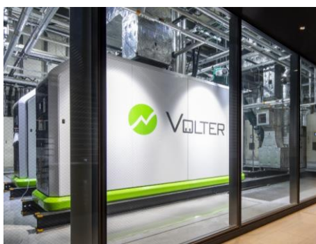
バイオマスガス化発電機
